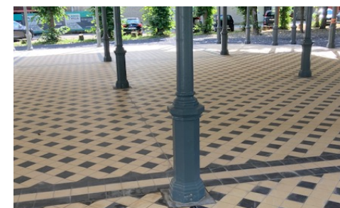
L'AWaP a demandé que la galerie ne soit plus utilisée avant la réception des travaux.
