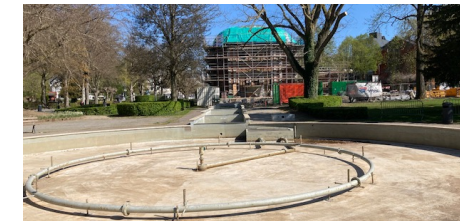
La fontaine attend une nouvelle pompe
