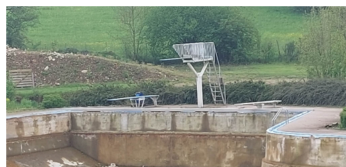
La fosse doit être rebouchée et les plongeurs supprimés.
