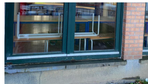
Les châssis de l'école de Creppe n'ont jamais été entretenus
