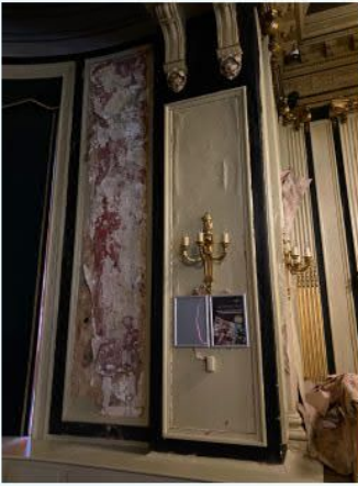
Dégâts à l'intérieur du casino causés par une infiltration d'eau
